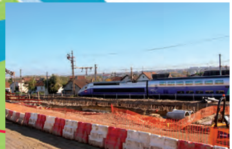
6. Gare des Saules Création d'une voie Tgv en tunnel souterrain. Fin des travaux : 2015.
