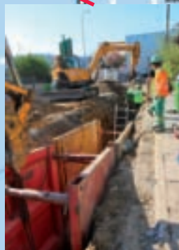
7. Cité-Jardins La ville d'Orly s'est engagée dans un programme d'enfouissement des réseaux Edf et France Télécom jusqu'en 2018. A la Cité Jardins, les travaux d'enfouissement sont partiellement achevés. Restera à réaliser la réfection de la voirie. Fin des travaux : juillet
